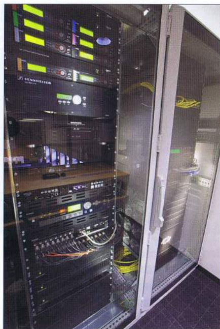
Die Technik ist ordnungsgemäß untergebracht.
